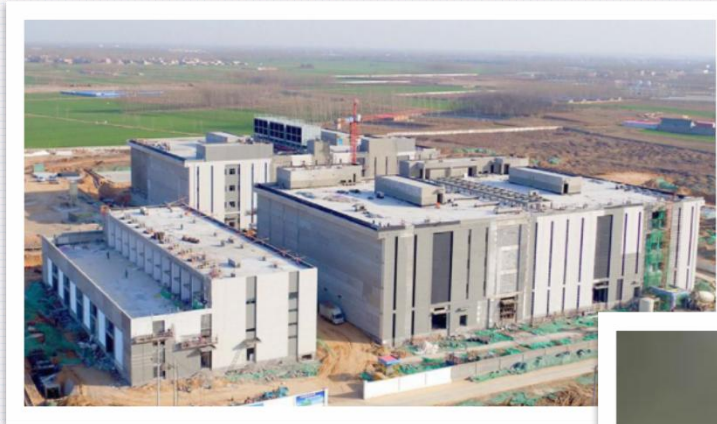
中国移动（河南） 航空港数据中心
